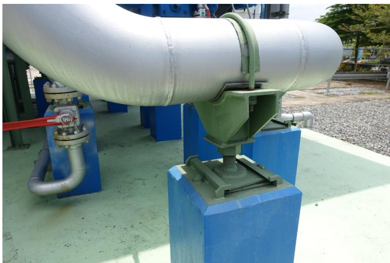
ภาพที่ 3 ฐานรองรับที่สามารถปรับระดับได้ ที่มา: บริษัทผลิตไฟฟ้าและน้ำเย็น (2558)
