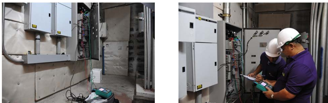
ภาพที่ 12 การตรวจวัดค่าชี้วัดทางไฟฟ้า
